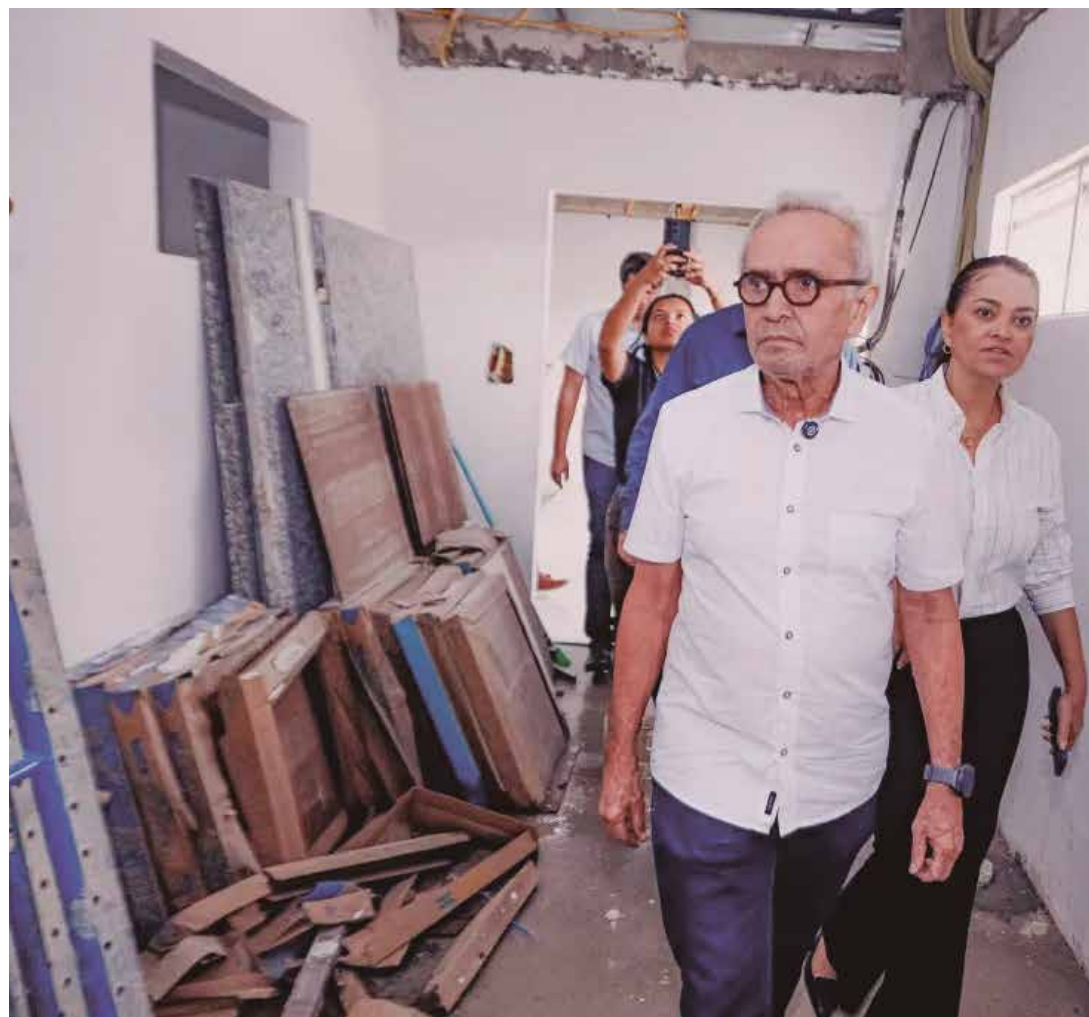
Cícero inspecionou os trabalhos que proporcionarão atendimento de mais pacientes com o quarto bloco da UTI do hospital
